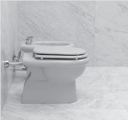
Vecchio impianto. Old installation.
