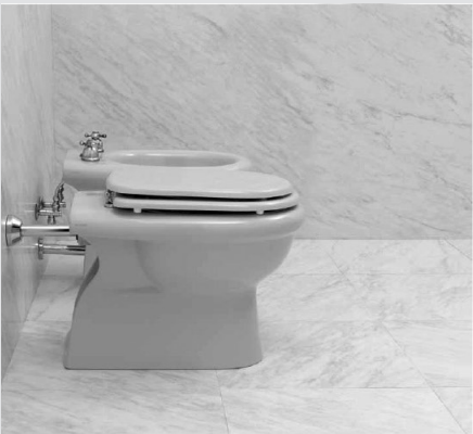
Vecchio impianto. Old installation.
