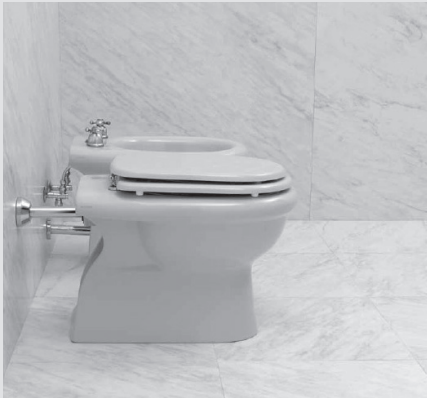
Vecchio impianto. Old installation.
