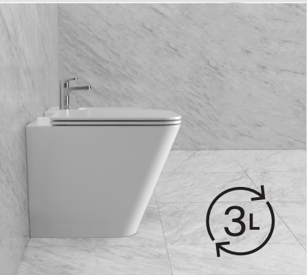
Vaso Build installato su vecchio impianto. Build wc installed on an old system.
